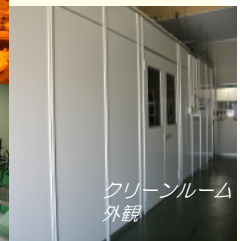
クリーンルーム
